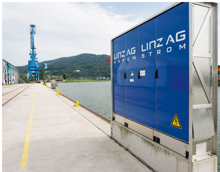
Der Linz AG Hafen stellt der Binnenschifffahrt insgesamt acht Landstromstationen zur Verfügung.
