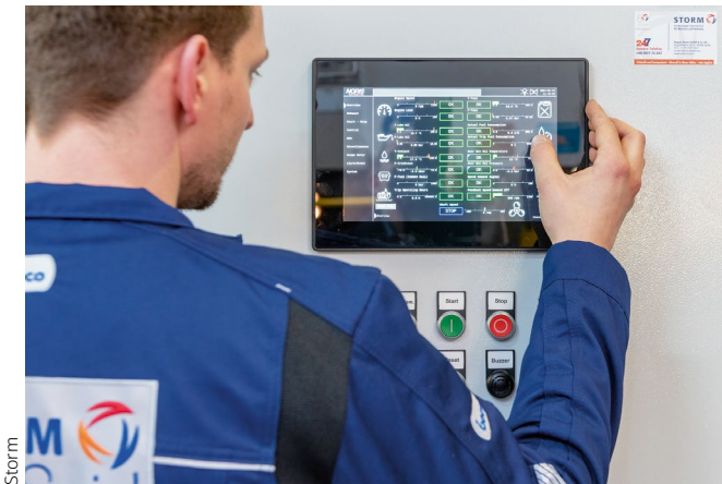
Ein Servicetechniker überprüft die Motorparameter am Local Operating Panel (LOP).
